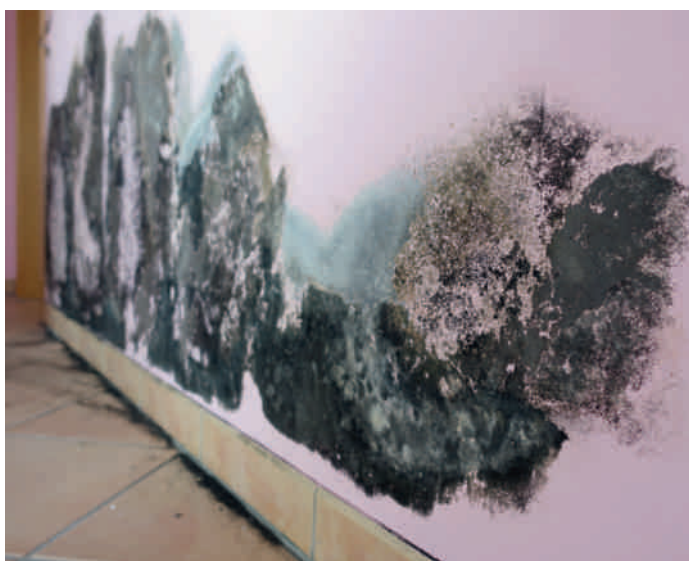
Bei der Beurteilung von sichtbarem Schimmelpilzwachstum müssen neben der Fläche des Schadens auch die Tiefe und Art des Befalls berücksichtigt werden. Schon ab einer flächigen Ausdehnung von mehr als 0,5 Quadratmetern wird der Befall mit der höchsten Kategorie 3 bewertet
