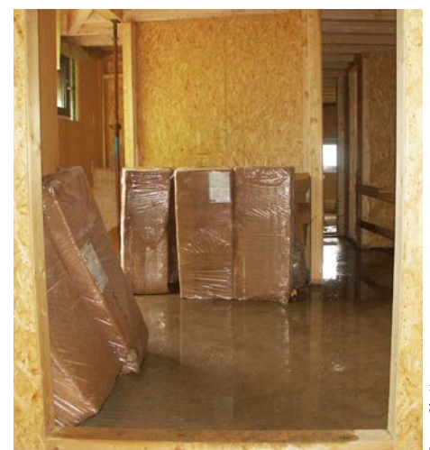
Havarie, durchfeuchtete Dämmmaterialien lassen sich nicht wirtschaftlich trocknen
